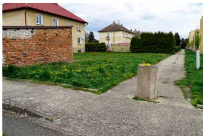
Chodníky na Mlejnici – původní stav
