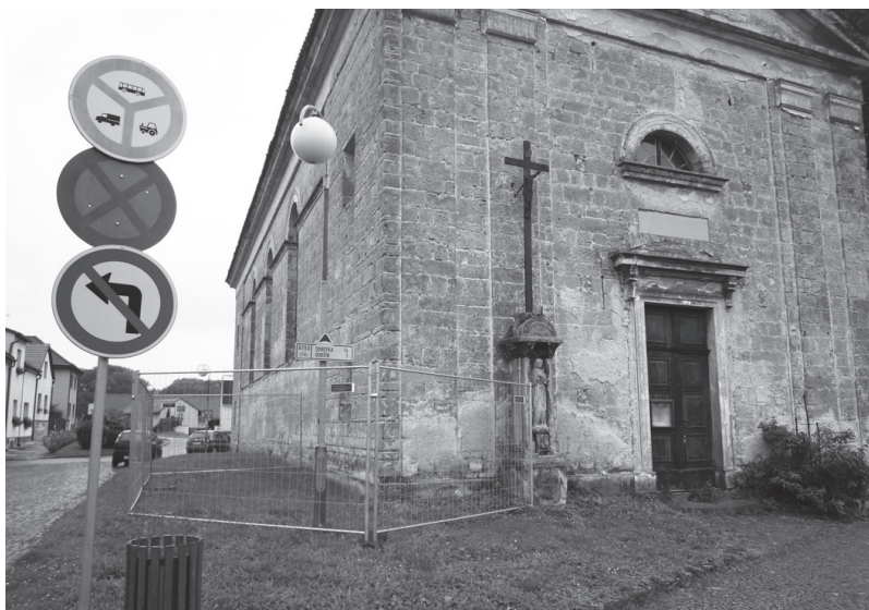
Střeža věže kostela, která je v havarijním stavu, se dočká opravy
